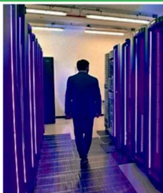
Un data center
